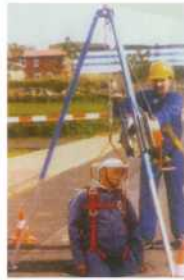
密閉空間設備 山腳架、吊機、氣體、測試儀
